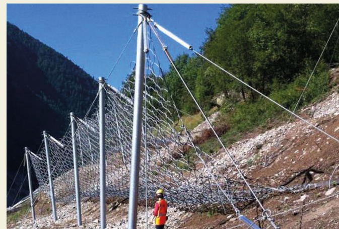
> Filets pare-blocs - photo : SCNF
